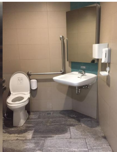
Penyediaan toilet untuk penyandang disabilitas
