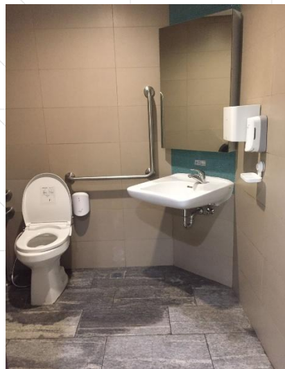
Penyediaan toilet untuk penyandang disabilitas
